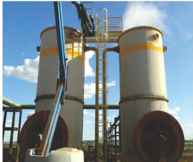
Aplicação de escada marinheiro e passarela em fibra (PULTRUDADO), para acesso de inspeção do acionamento mecânico.
