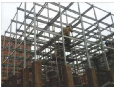
Substituição da estrutura de aço, para nova estrutura fabricada em fibra (PULTRUDADO).
